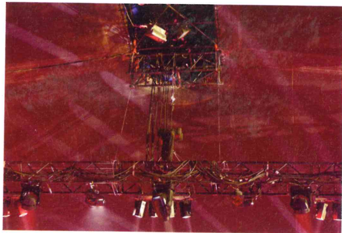
Pas de pilier, l'ensemble des câbles remonte donc dans la canopée avant de redescendre par l'extérieur du chapiteau.
